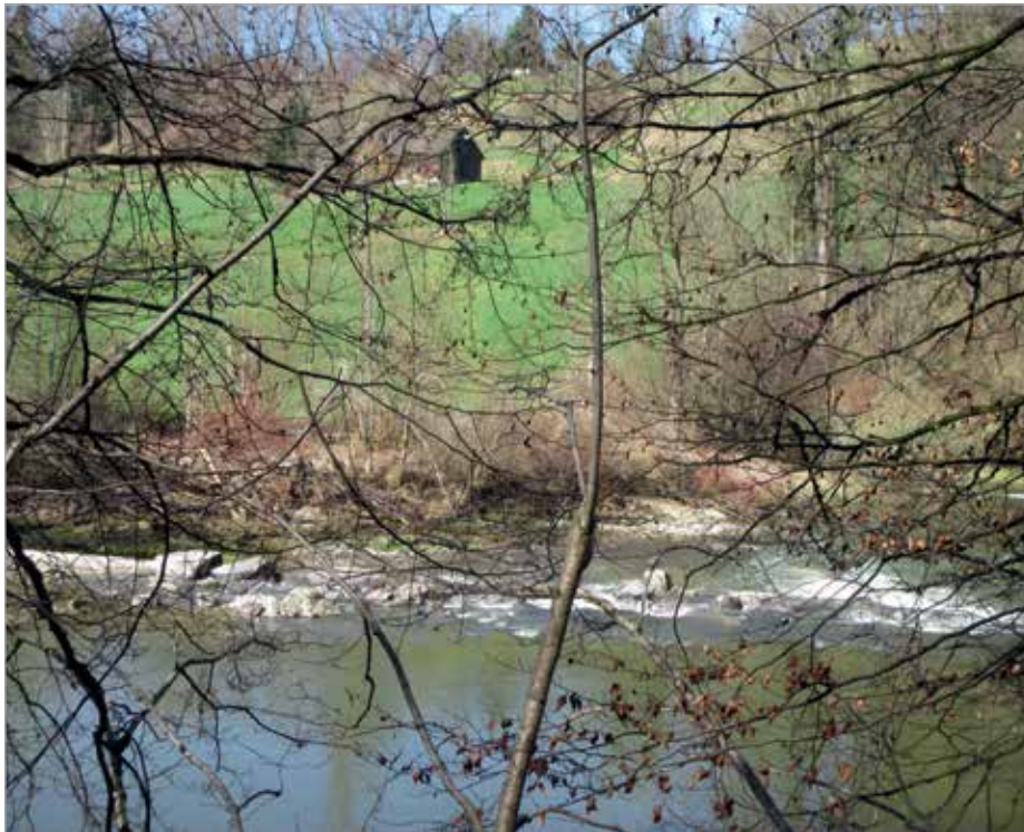
Die alte, zum Teil verfallene Schwelle in der Sitter, welche abgebrochen wird. Das neue Kraftwerk entsteht unmittelbar oberhalb davon. Bild: Veronika Meyer.
